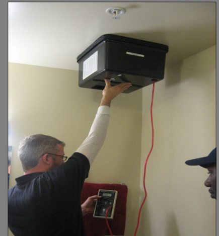
Exhaust Fan Testing
